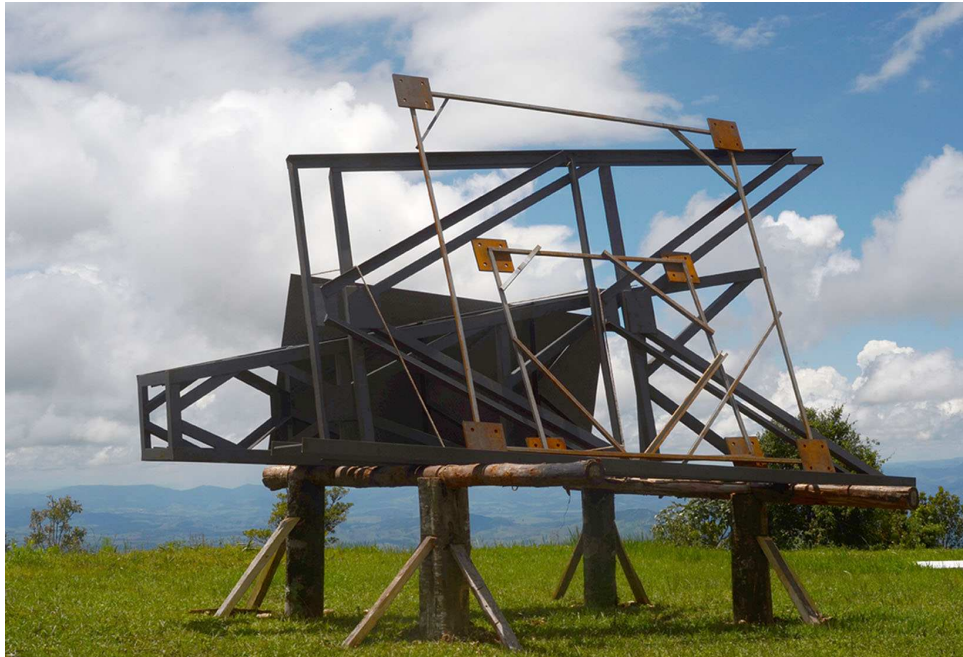
Fig. D.1 - As estruturas das torres apoiadas em cavaletes. A torre interna está concluída faltando apenas a soldagem das sapatas. A torre externa necessita ter as laterais soldadas umas às outras. Os gabaritos para posicionamento das estruturas sobre as bases são vistos em 1º. Plano.
